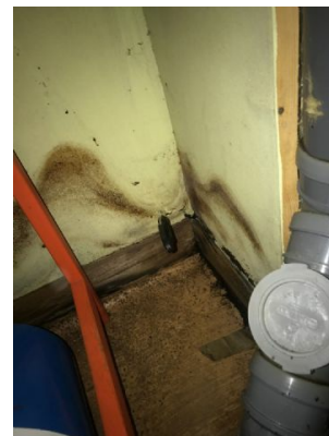
Fuktskader i utlektet vegg
