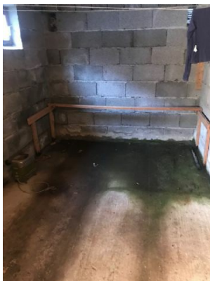
Fukt i kjeller
