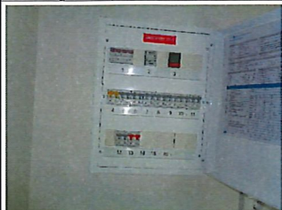
Sikringssskap med automatsikringer.
