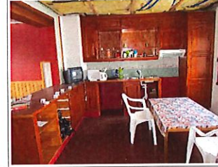
Kjøkkenen 1. etasje. Totalskadet.
