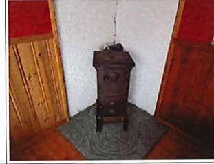
Brudd i pipe.
