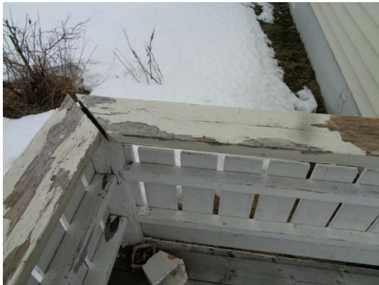
Avflassing/råteskader på balkong.
