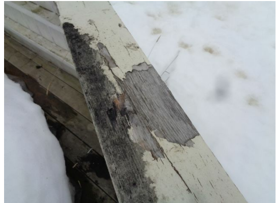
Råteskader og avflassing på balkong.
