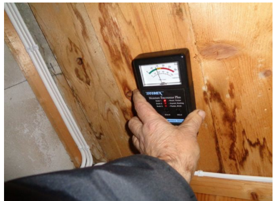
Etter fuktindikasjonsmåling i himling under kjøkken er det målt forhøyet verdier.
