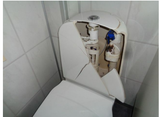
Sisterne i wc har frosset og sprengt i stykker.
