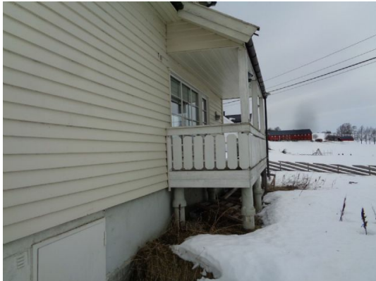
Slitt overbygd balkong.
