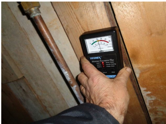
Etter fuktindikasjonsmåling i himling under bad er det målt forhøyet verdier.
