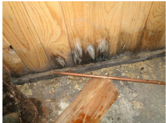
Fukt og råteskader i trevegg i kjeller.
