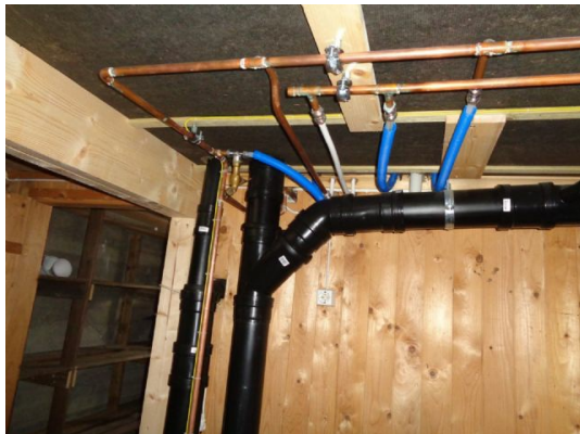
Nyere røropplegg i kjeller.
