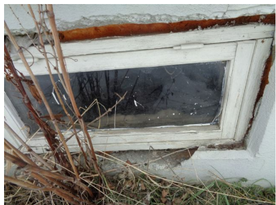
Mangler ferdigstilling rundt kjellervindu.
