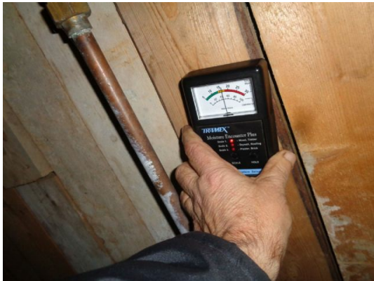
Etter fuktindikasjonsmåling i himling i kjeller under bad er det påvist forhøyet verdier.
