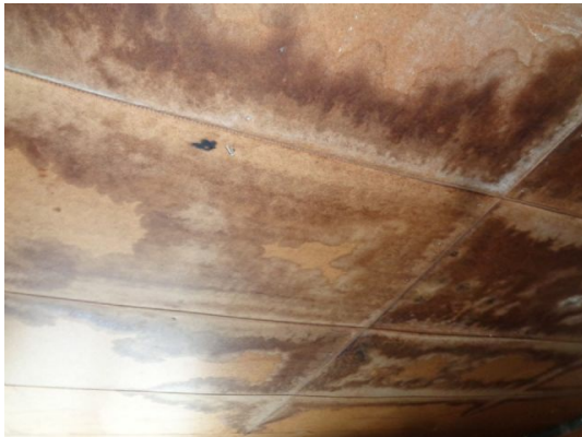
Fukt i himling i innredet rom i garasje/uthus.
