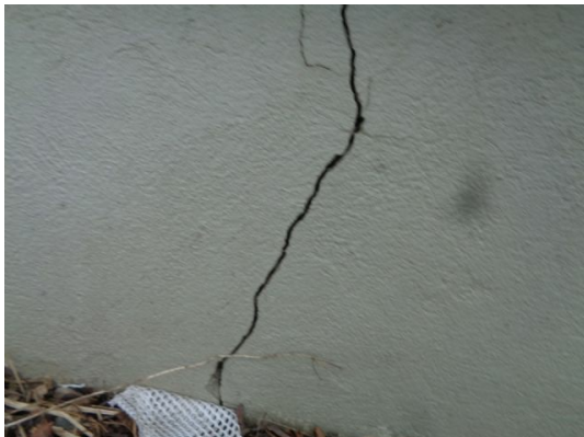
Sprekk i grunnmur.
