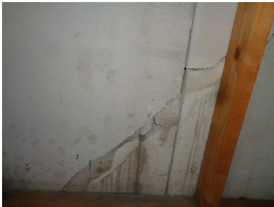
Sprekker i ytongplank i kjeller.
