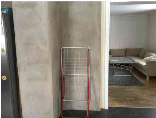
Elementpipe, sprekk i brannmur
