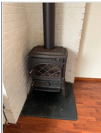
Bildet viser boligens vedovn.
