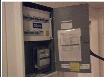
Sikringskap i underetasje.
