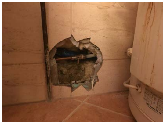
Defekt membran etter vannlekkasje i vegg.
