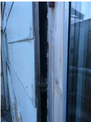
Åpent mellom veggkonstruksjon og kledning.
