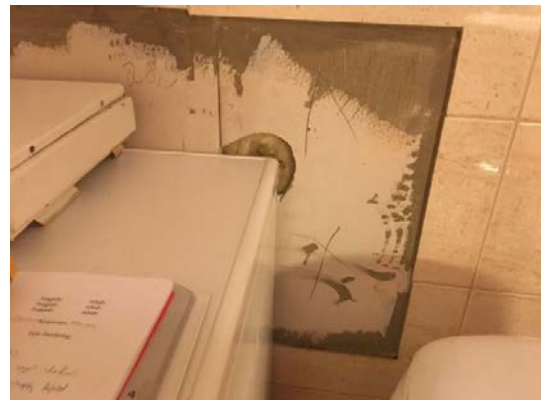
Igjenkledd vindu. Manglende fliser og membran samt punktert veggplate.
