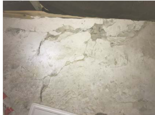
Sprekker og krakeleringer i pusslaget
