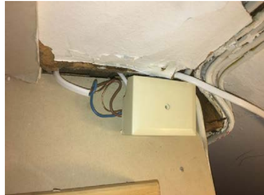
Ikke fagmessig utførelse.
