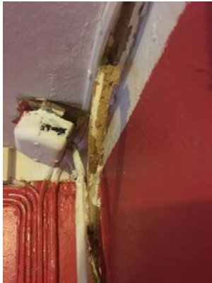
Koblingsboks og løs kabel.
