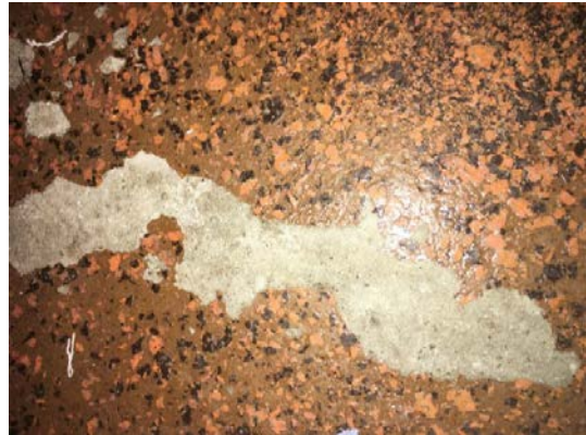
Defekt belegg på vaskerom.
