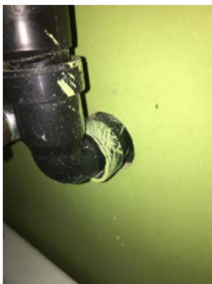
Veggjennomføring uten tetting.
