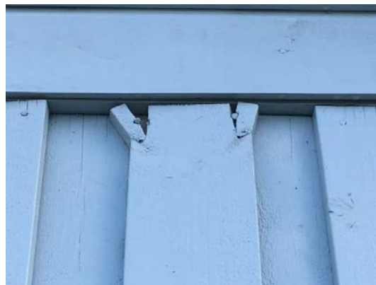
Feil spikring av panelet.
