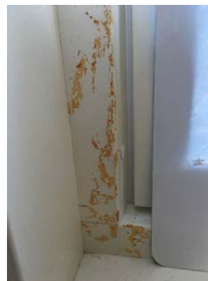
Fugeskum på innvendig karm.
