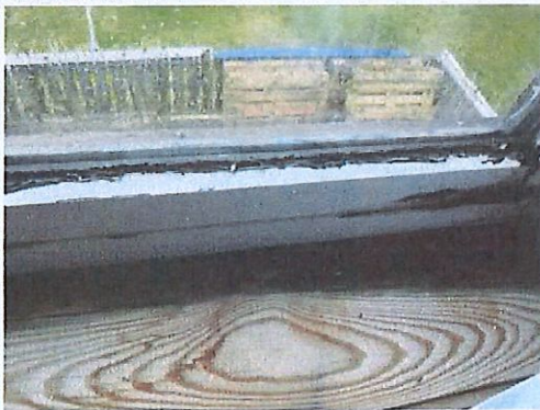
Vindu soverom. Alle vinduer i andre etasje har lekkasje.
