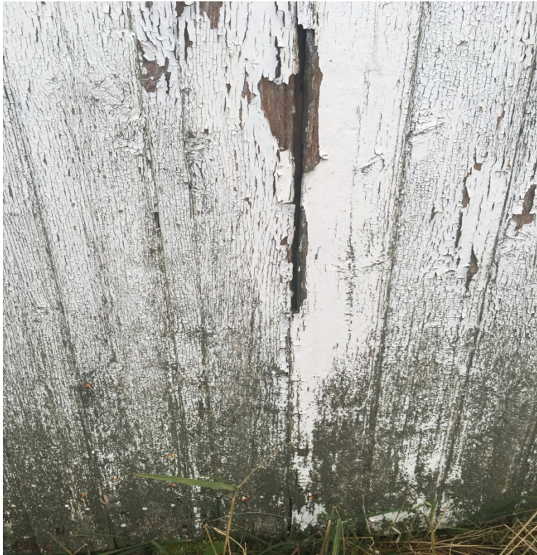
Bilde 3. Stående trepanel, ikke vedlikeholdt.
