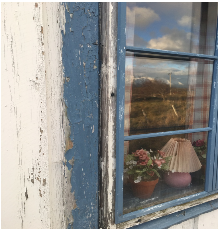
Bilde 4. Provisorisk innsatt vindu.
