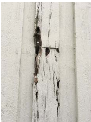
Råte i utvendig kledning
