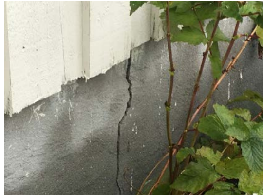
Sprekk i ringmur.
