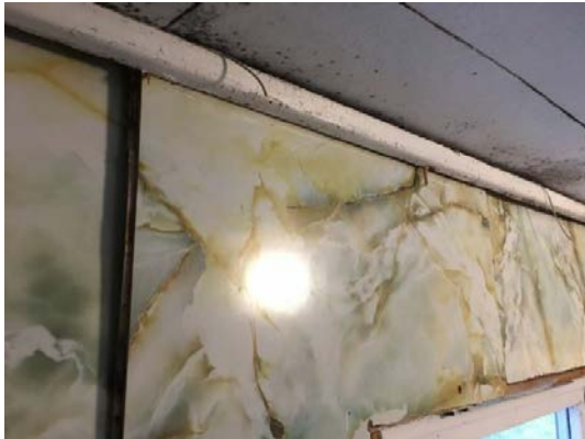
Defekte veggplater bad.
