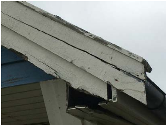
Skader vindski og raftekasse.
