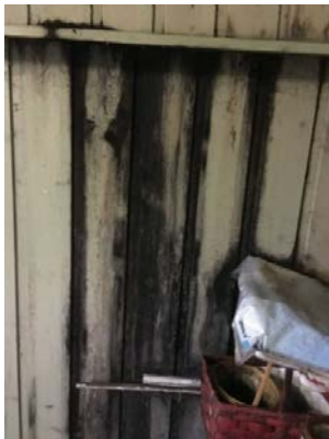
Vannskadet veggpanel i kjeller.
