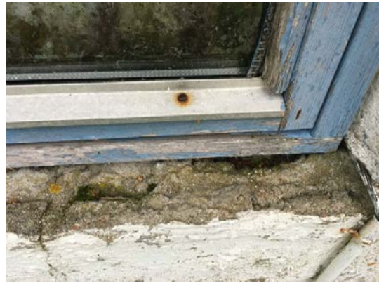
Kjellervindu ikke fagmessig montert.
