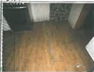
Gulv kjøkken, laminat på belegg. Ødelagt av fukt.
