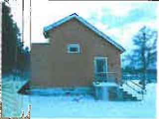
Maling flasser av, både på bordkledning og mur.
