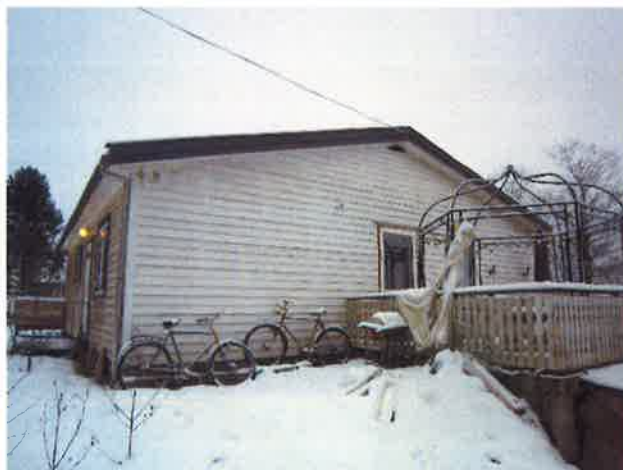
Balkong over inntilbygget garasjejedel
