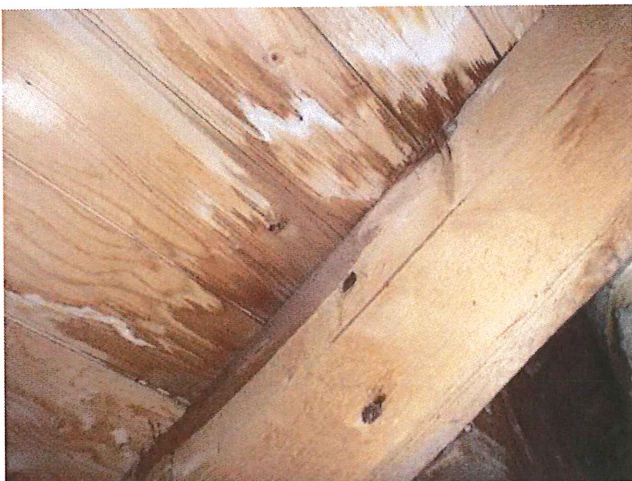
Fuktmerker på tro.
