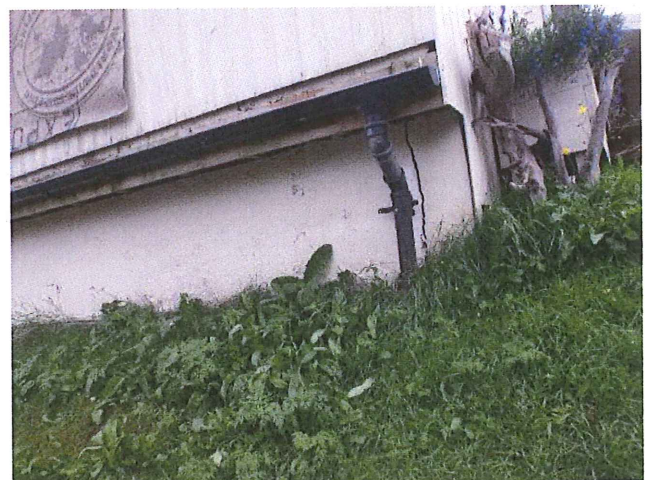
Sprek i mur på tilbygget garasje.
