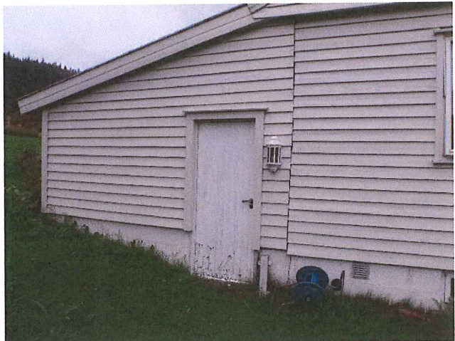
Sprekk i mur mot tilbygget uthus
