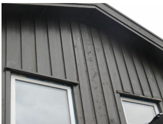
Råteskader på panel over vinduer og i bunn.
