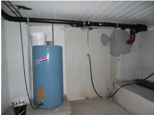
Noe avflassing på vegger i kjellerrom.
