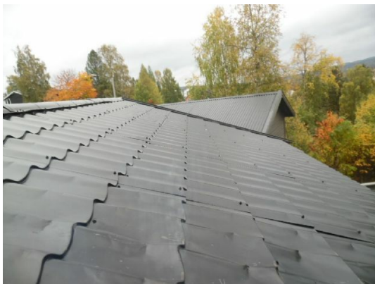
Bulket og slitt takteking over eldre del.
