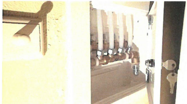
Koblingsskap for vann.
