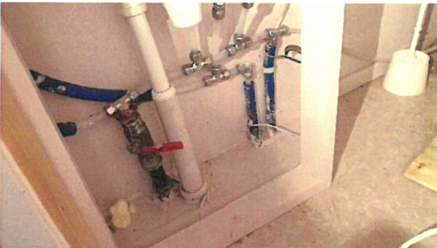
Rørplegg i toalett.
