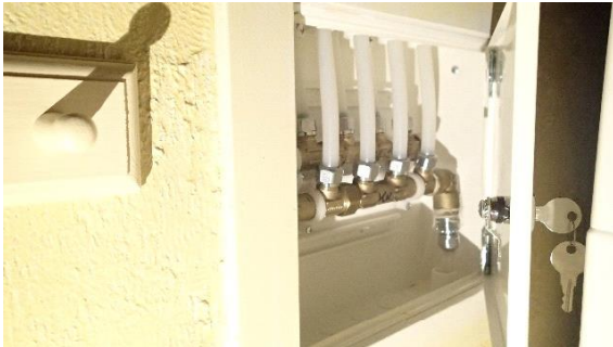
Koblingskap for vann
