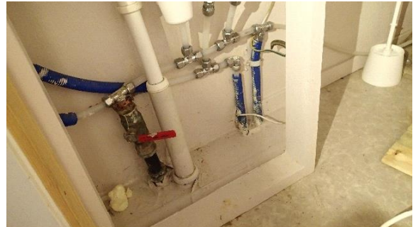
Rørplegg i toalett
