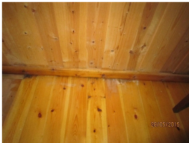
Tydelige tegn på fukt/vannskader i soverom.
