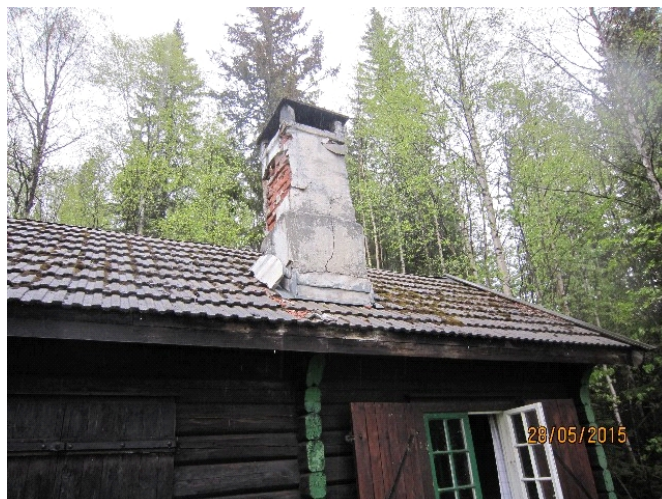
Pipe er i dårlig stand.
