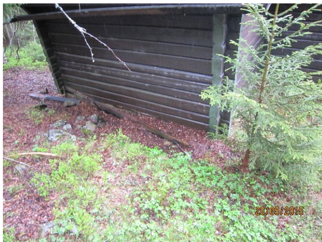
Utvendig treverk på bakvegg er utsatt for fukt-/råteskader.
