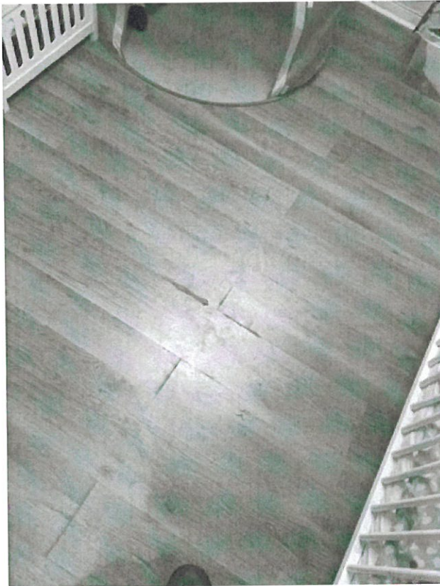
Skade gulv sov loft etg.
