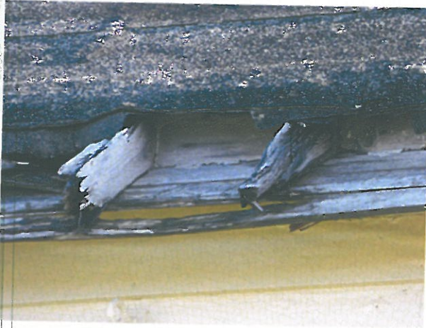
Skader på tak
