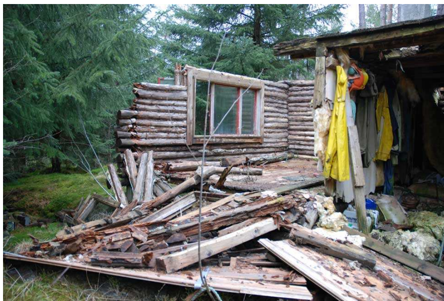
Objekt 2, se kulturminnekart side 13, eldre trebygning som står til nedfall.
