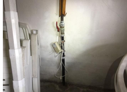
Stoppekran plassert i kjeller.
