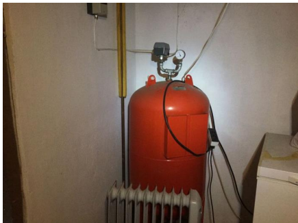
Trykktank plassert i kjeller.
