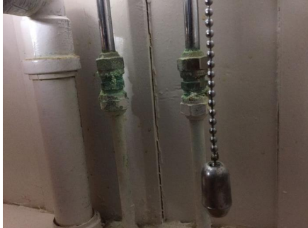
Irr på rør registrert.
