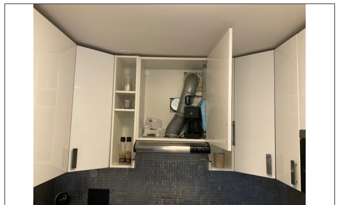
Kontroll av ventilator.
