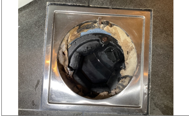
Kontroll av sluk på bad.
