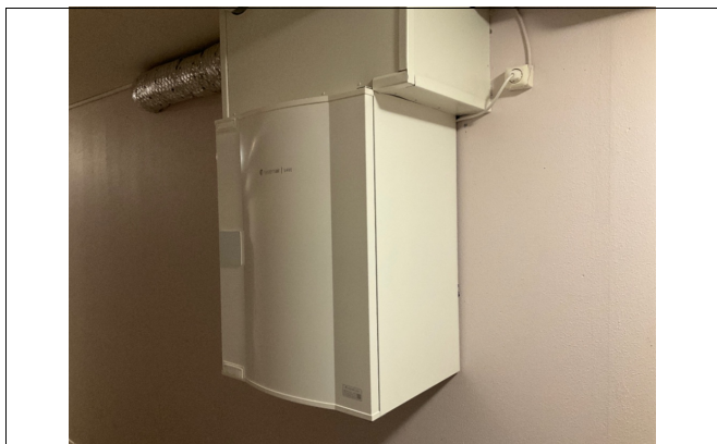
Balanser ventilasjon. aggregat plassert i felles gang.
