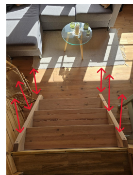
Bildet viser tretrapp med manglende rekkverk.
