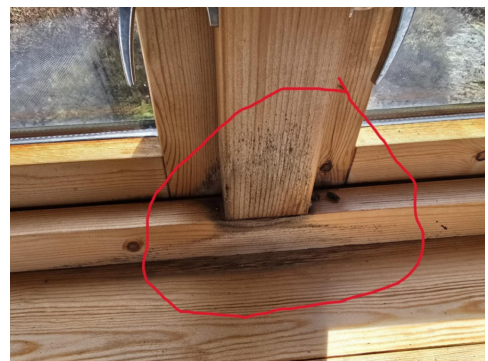
Bildet viser vindu i stue som har fått noe fuktskader i innvendig treverk.
