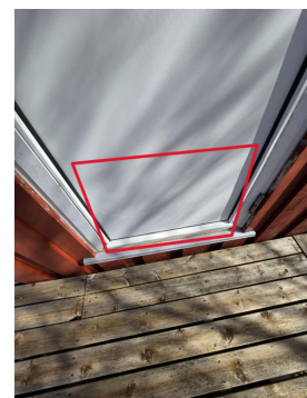
Bildet viser nedre del av altan døren som er fuktskadet.
