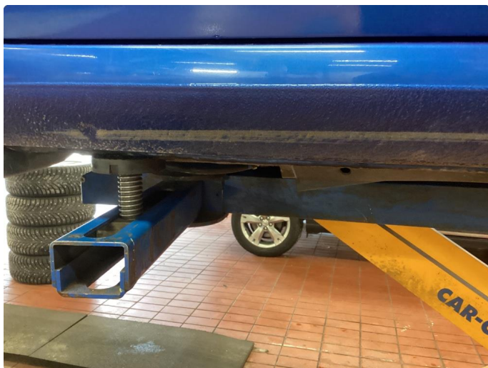
1.4 Litt rust og en liten skade
