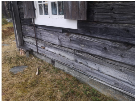
Gammel uttørket råteskade på tømmervegg.
