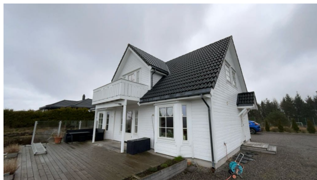
Ikke montert snøfangere
