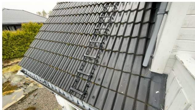
Litt mose på taksteinen.
