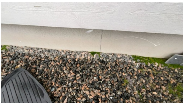
Sprekk i ringmur.
