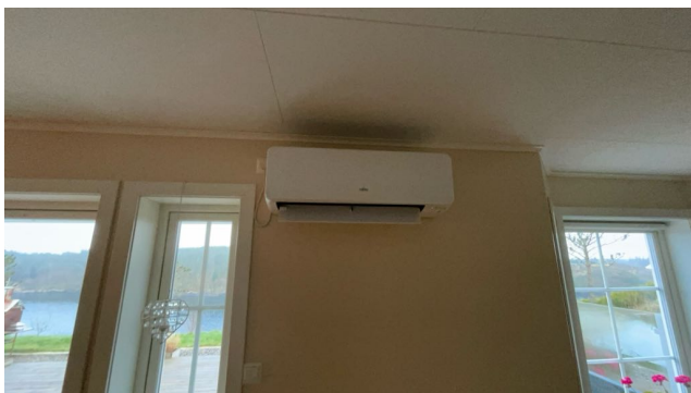
Varmepumpe i stue
