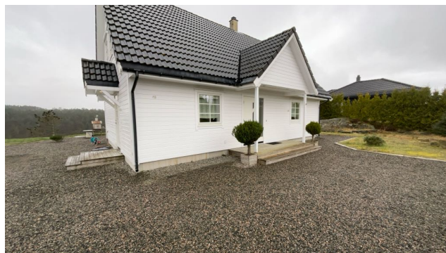
Ikke montert snøfangere
