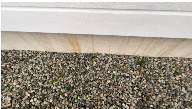
Sprekk i ringmur.
