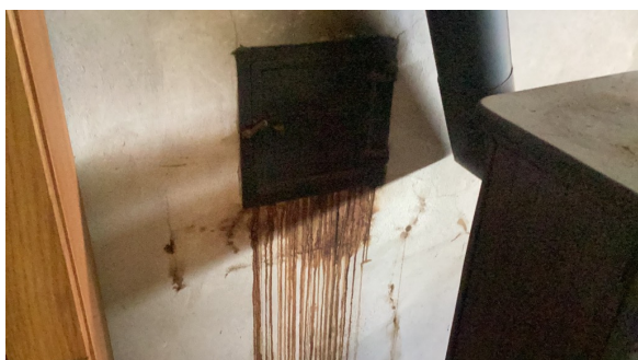
Eksempel på sotluke i kjeller.
