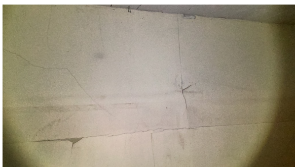
Eksempel på sprekker.
