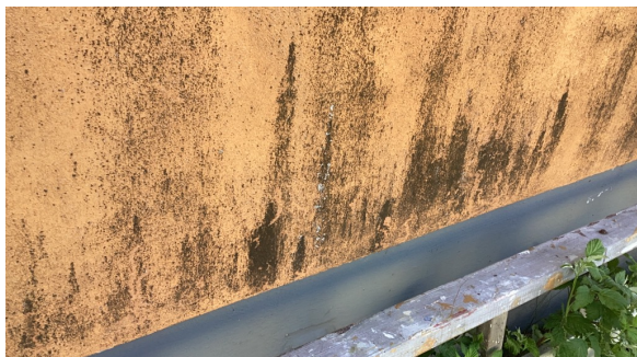
Eksempel på misfarging.
