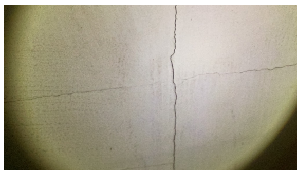
Eksempel på sprekker.
