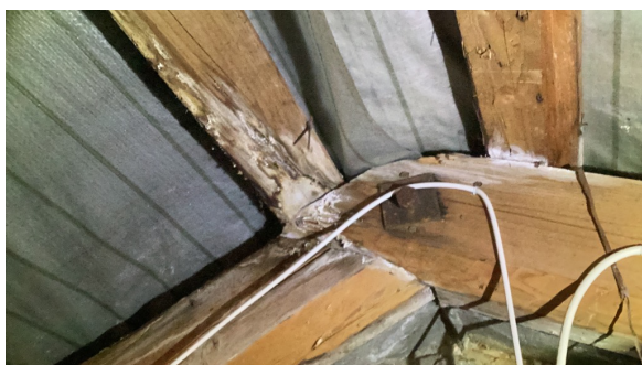
Fuktmerker rundt pipe.
