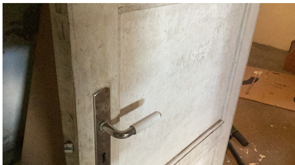
Eksempel på slitasje.
