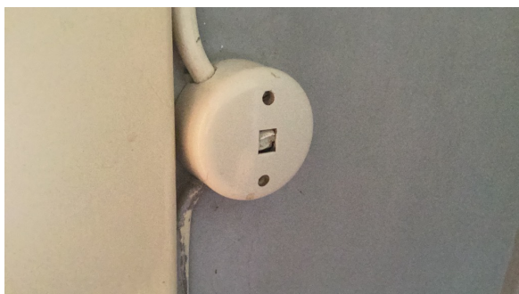
Eksempel på skade på lysbryter
