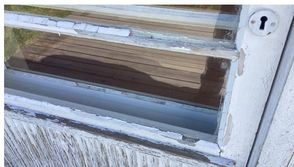
Kraftig slitasje på verandadør.
