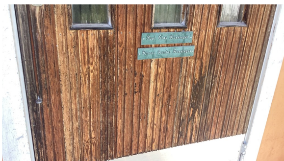
Slitasje på entredør
