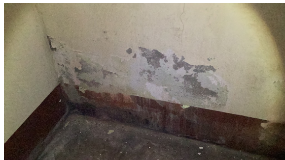
Eksempel på fuktpåkjenninger.
