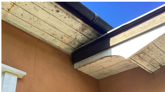
Eksempel på utvendig slitasje.
