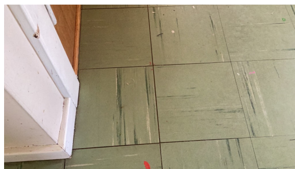
Glipper mellom vinylfliser.
