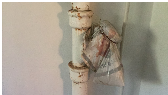
Forgrening som er forseglet med pose, det er vann i pose. Ukjent årsak til dette.
