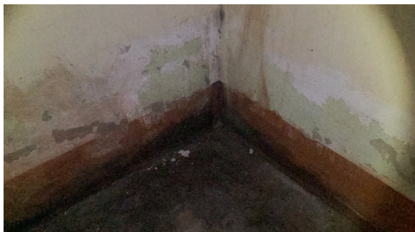
Eksempel på fuktpåkjenninger.
