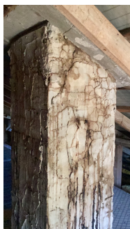
Eksempel på tilstand på pipe på loft
