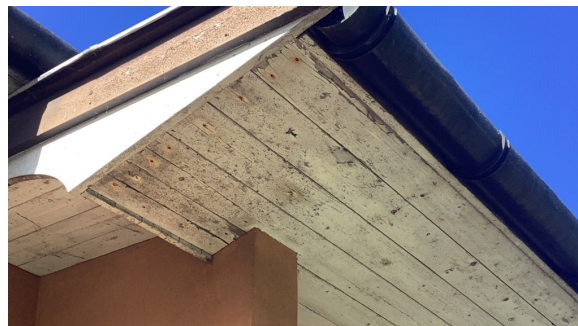
Eksempel på utvendig slitasje.
