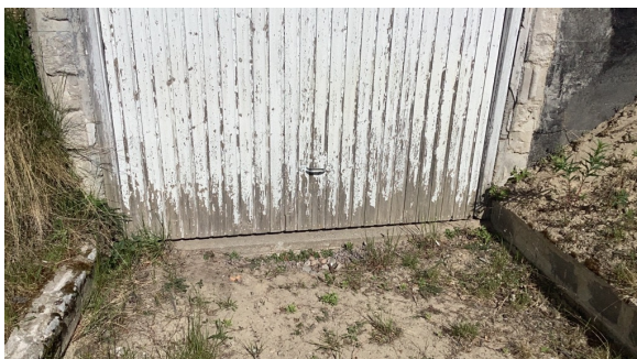
Kraftig slitasje på garasjeport.
