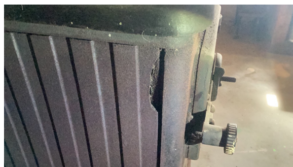
Skade på vedovn i kjeller.
