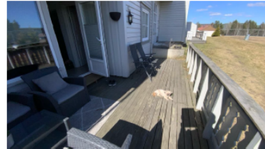
Skjevheter i terrasse.
