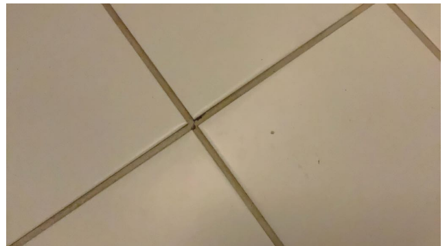
Det er observert hull i flisfuge.
