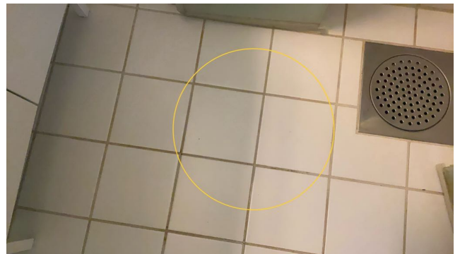
Det er oppdaget noen fliser med bom/ hulrom.
