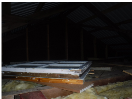
Ltt skrot på kaldloftet
